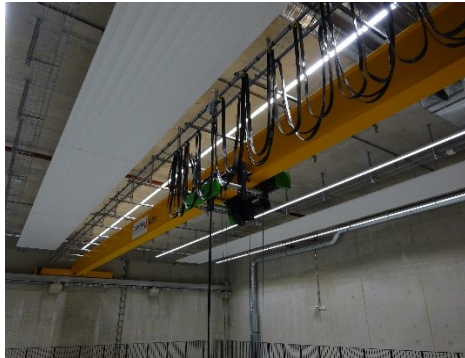
Der Brückenlaufkran besitzt eine Tragkraft von 5 t und eine Nennleistung von 5,6 kW
