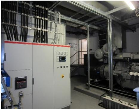
Notstromsteuerung der NEA
