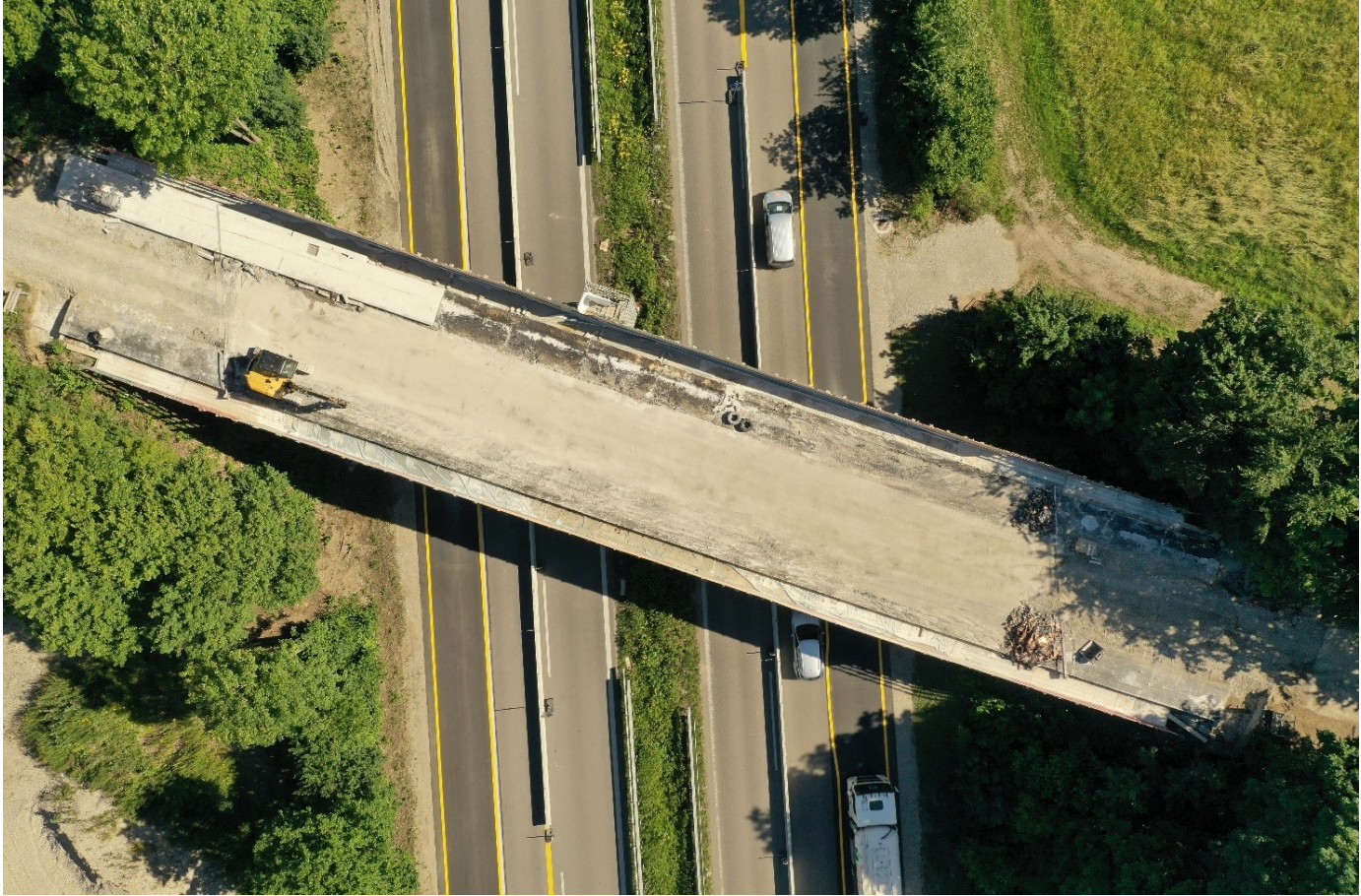
BW 517 Abbrucharbeiten auf dem Überbau, darunter vierstreifige Baustellen-Verkehrsführung der B 17 durch Fahrbahnverbreiterungen
