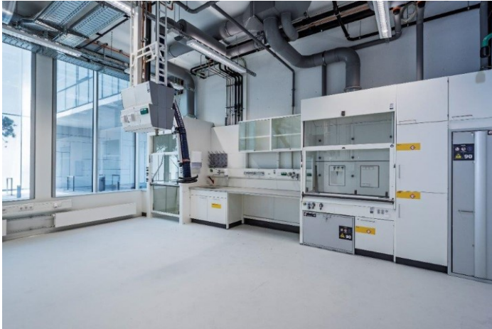
Laborbereiche mit Digestorien
