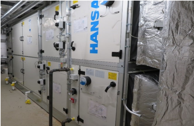
Nachher: RLT-Anlage Schwimmhalle (16.000 m³/h) mit Wärmerückgewinnung
