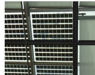
Dachintegrierte PV- Module
