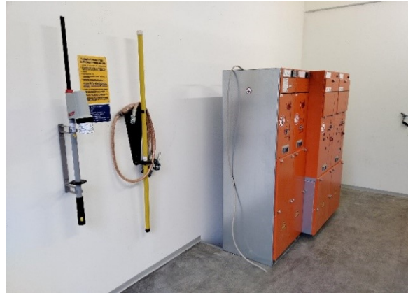
Mittelspannungsschaltfelder mit Spannungsprüfer
