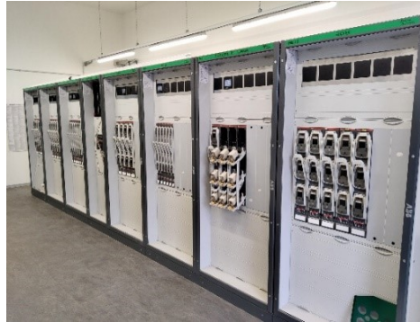
Lasttrennschalter der Abgangsfelder der NSHV
