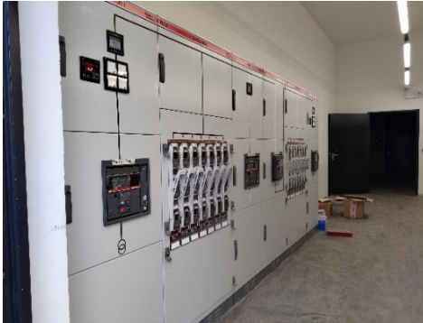
Niederspannungshauptverteilung (NSHV) mit Einspeisefeld
