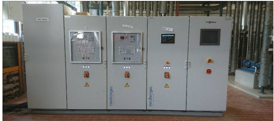
Ersetzte Schaltschränke zur Regelung aller Kessel
