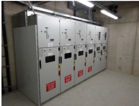
Mittelspannungsanlage für zwei Transformatoren mit je 630 kVA inkl. zwei Reserveabgangsfelder
