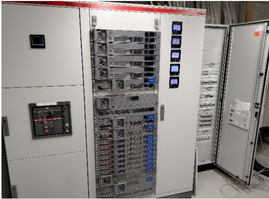
Niederspannungshauptverteilung der Raumschießanlage mit horizontal eingebauten Lasttrennschalter
