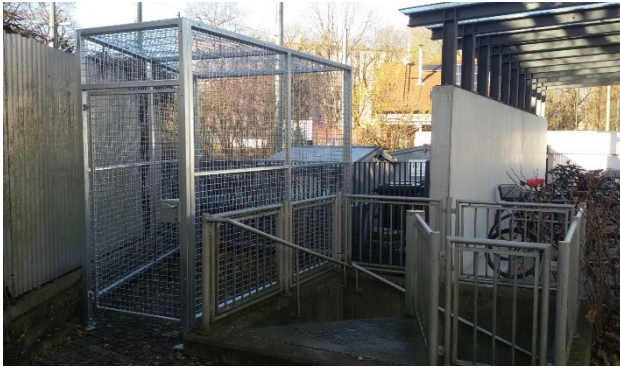
Installation Aufbewahrungsbox zur Lagerung Außenmöbel
