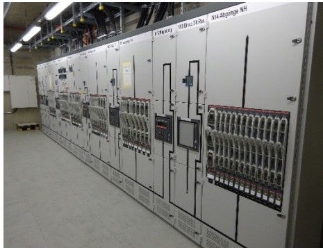
Niederspannungshauptverteilung mit NH00/NH1/NH2-Abgängen für die Versorgung der Stockwerksverteilung
