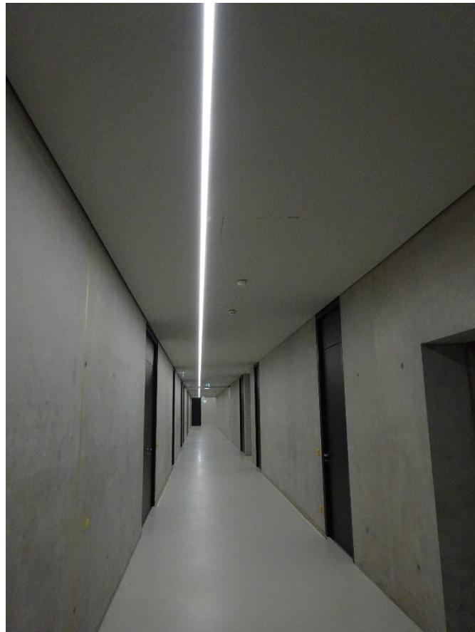
Schmale Anbauleuchte als Lichtband in der Streckmetalldecke integriert - Laborflur
