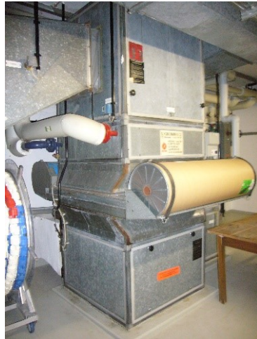
Vorher: Getrennte Zuluftanlage Nebenräume mit Rollbandfilter
