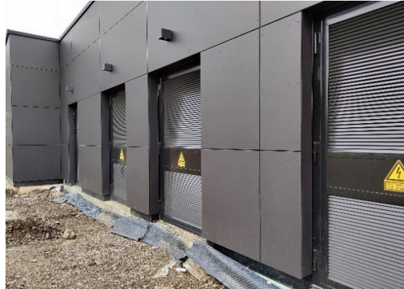
Mittelspannungsstation von außen
