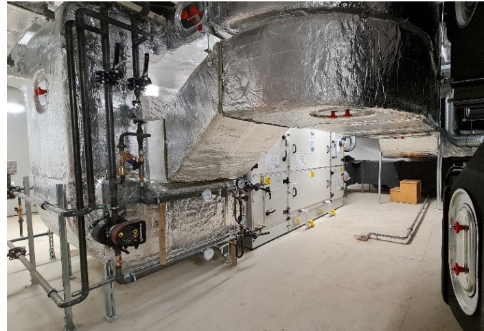
Nachher: Neue RLT-Anlage Nebenräume ( 4.500 \text{ m}^3/\text{h} ) mit Kreuzstrom-Plattenwärmetauscher
