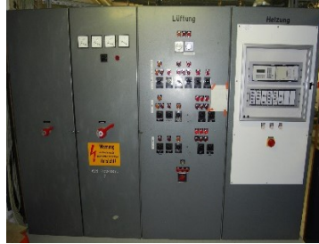
Vorher: Alte Schaltschränke Lüftung, Heizung & Elektro
