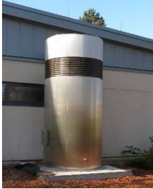
Kombinierter Außen- und Fortlufturm ( \varnothing = 2 \text{ m} )
