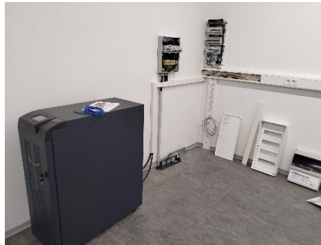
Unterbrechungsfreie Stromversorgung für die Datenverteiler
