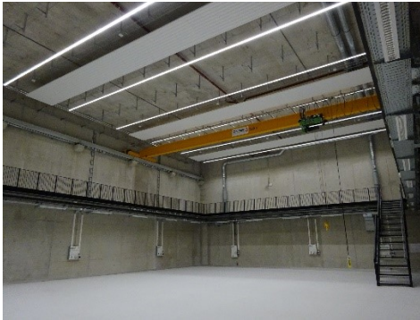
Versuchshalle mit einem Brückenlaufkran
