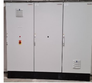
Nachher: Neue Schaltschränke mit Aufschaltung auf GLT
