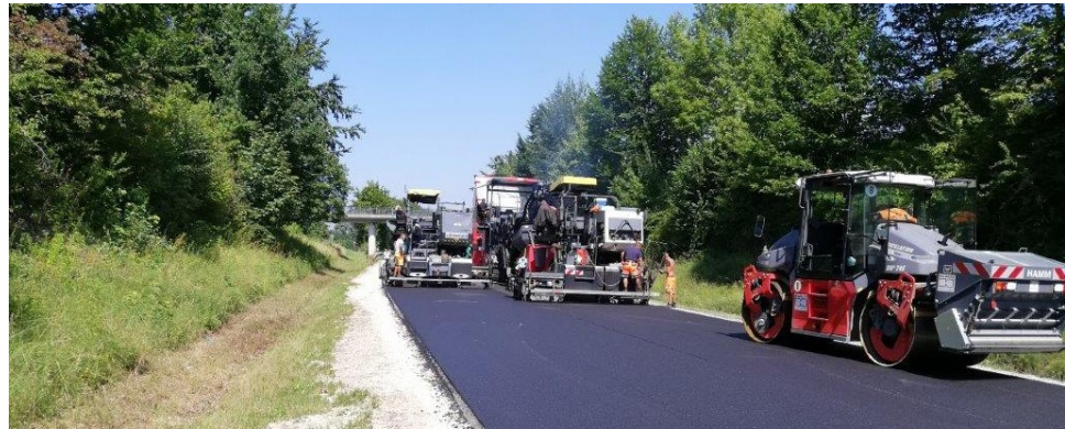
Durch den parallelen Einsatz zweier Fertiger kann eine Asphalttschicht in voller Fahrbahnbreite hergestellt werden
