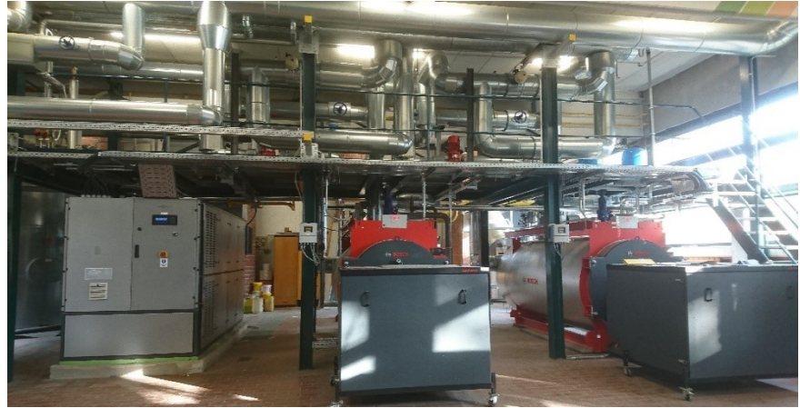
BHKW mit 363 kW thermischer und 238 kW elektrischer Leistung und zwei neue 2,3 MW-Gaskessel
