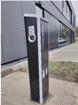
22 kW-Ladesäule für E-Autos
