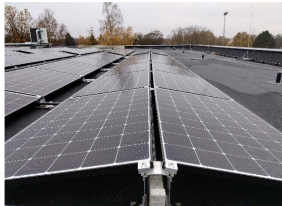
Ost-West-Ausrichtung der PV-Module für eine bessere Ausnutzung der Sonneneinstrahlung
