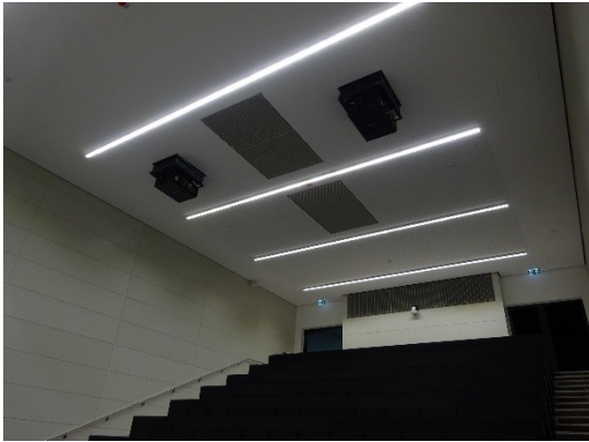
Einbauleuchte, waagrecht zur Fassade, im Deckensegel eingebaut - Seminarraum
