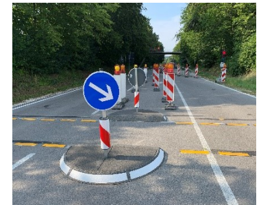
Provisorische Fußgänger-Querungshilfe wegen Vollsperrung der Geh-/Radwegbrücke im Hintergrund
