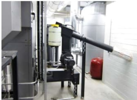
Pellet-Fördereinrichtung mit Zellenradschleuse
