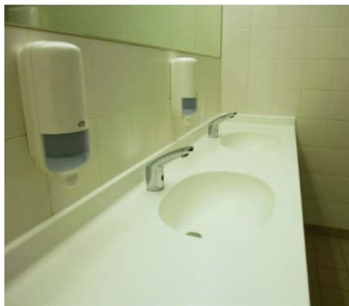
Waschtische mit akkubetriebener Infrarotsteuerung
