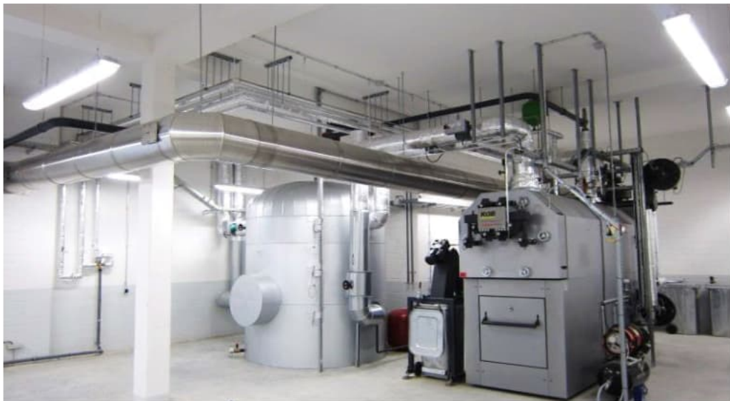
Pellet-Kesselanlage ca 530 kW, Aufstellung in neuem Heizraum innerhalb des ehemaligen Kohlebunkers
