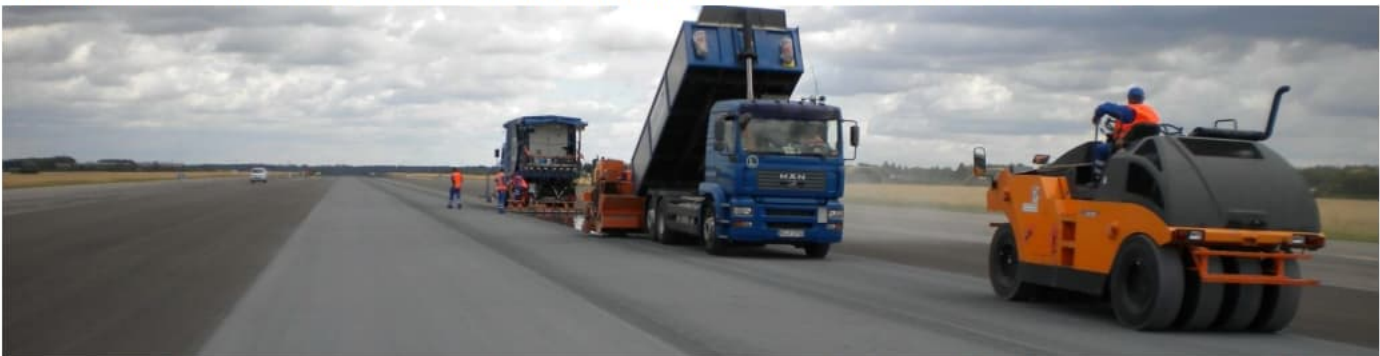
Einbau des Anti-Skid-Belags: Aufbringen der polymermodifizierten Epoxidharzschicht, Abstreuen mit Basaltedelsplitt 1,5 – 3,5 mm, Anliefern Abstreumaterial, Walze
