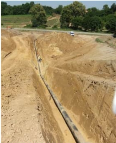
Verlegtes Rohr im Rohrgraben - gegenüberliegende Straßenseite noch unbearbeitet, Straßenkreuzung im Bestand erhalten
