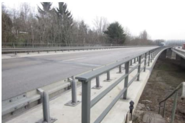
Östlicher Überbau mit Fahrbahnschäden
