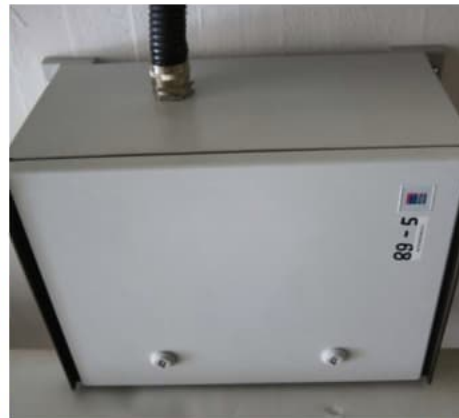
Gegen Vandalismus geschützte Antenne im Gebäude
