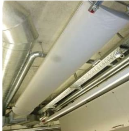
Lüftungsauslass mit Textilfilter
