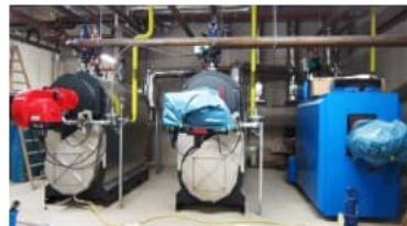
3 Brennwert-Gaskessel vor Inbetriebnahme
