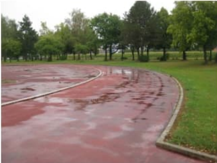
In die Jahre gekommene Tartanbahn: abgenützter Belag und Pfützen auf der Laufbahn
