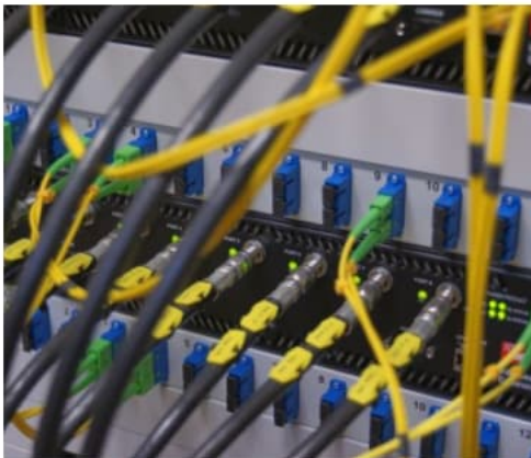
Antennenverteiler im Zellengebäude
