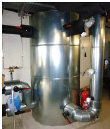
Pufferspeicher für Kaltwasser
