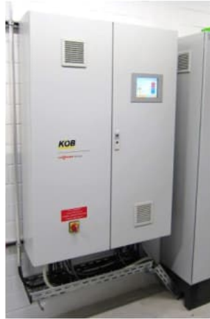
Schaltschrank der Kesselanlage
