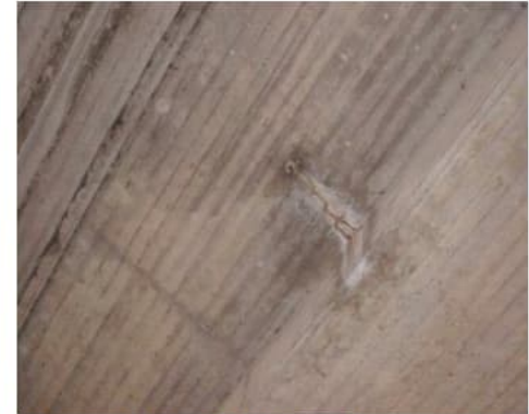
Typisches Schadensbild: Durchfeuchtung
