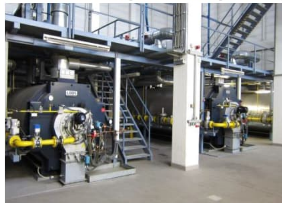
Bestehende Gas-/Öl-Kesselanlage in der ZVA Geb 53, ca 14 MW, zur Fernwärme-Versorgung der Lechfeldkasene
