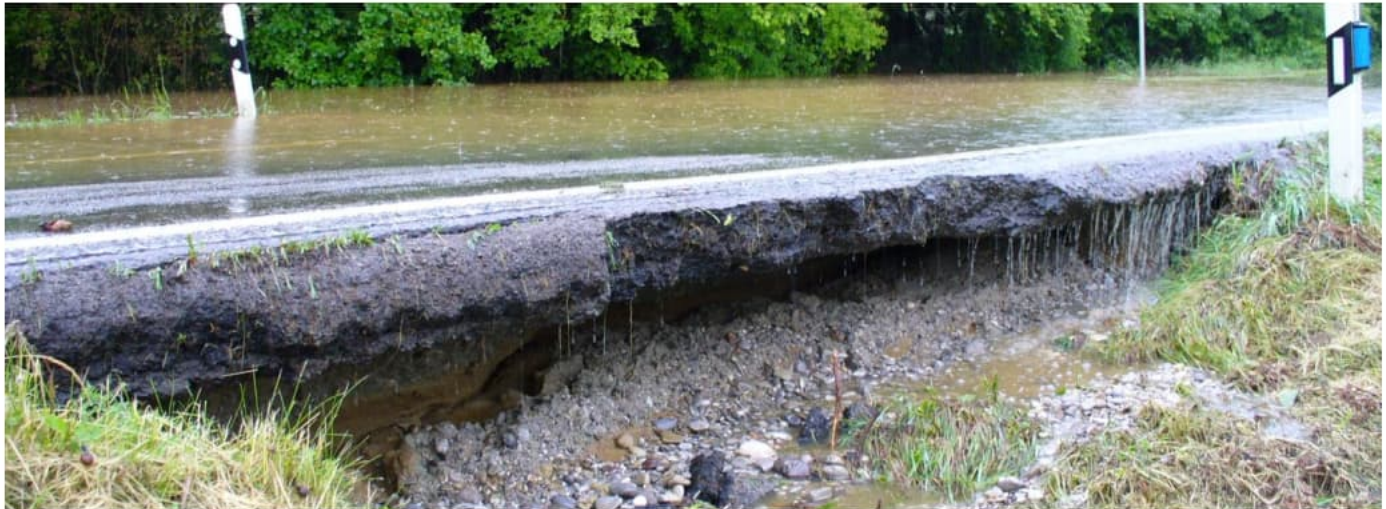
Das Hochwasser 2013 und die Schäden
