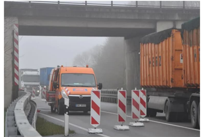
Derzeitige Situation mit Engstelle
