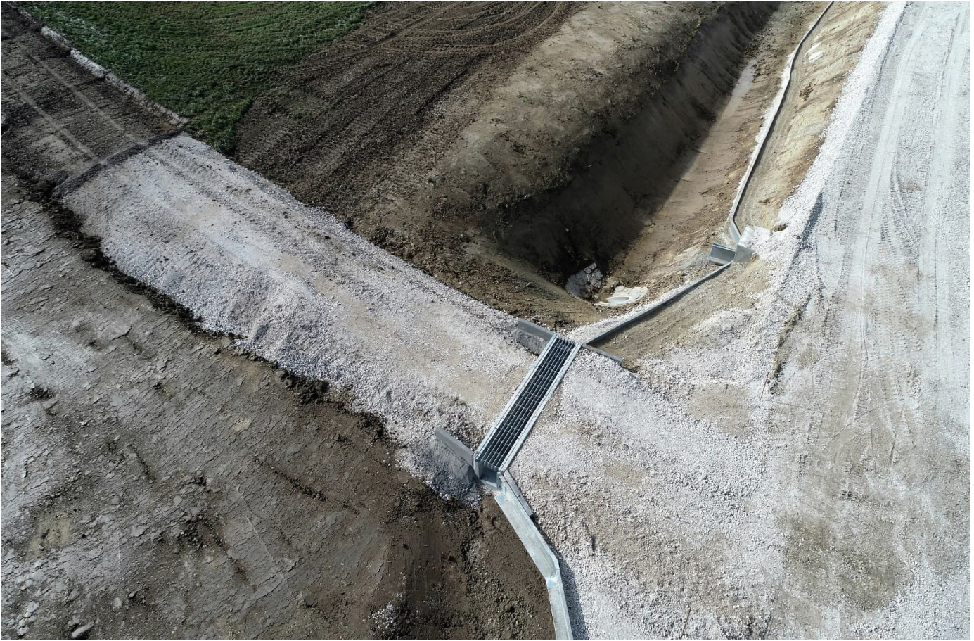
Amphibienleiteinrichtungen im Straßenbau – in der Bildmitte eine Querung eines einmündenden Wirtschaftsweges mit Gitterrost, Leiteinrichtungen sowie ein Durchlass.
