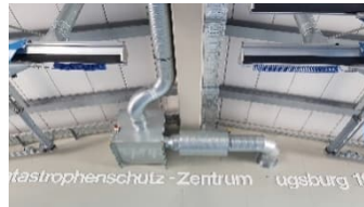
Ventilator der Abgasabsauganlage
