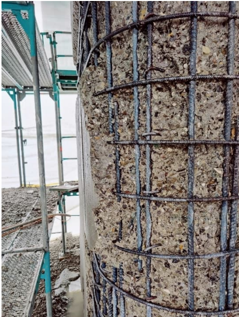
Sichtbare Bewehrung des Pfeilers nach Betonabtrag
