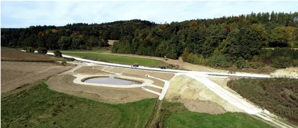
Das neue Regenrückhaltebecken dient der Entwässerung sowohl der Straße als auch des Radweges.
