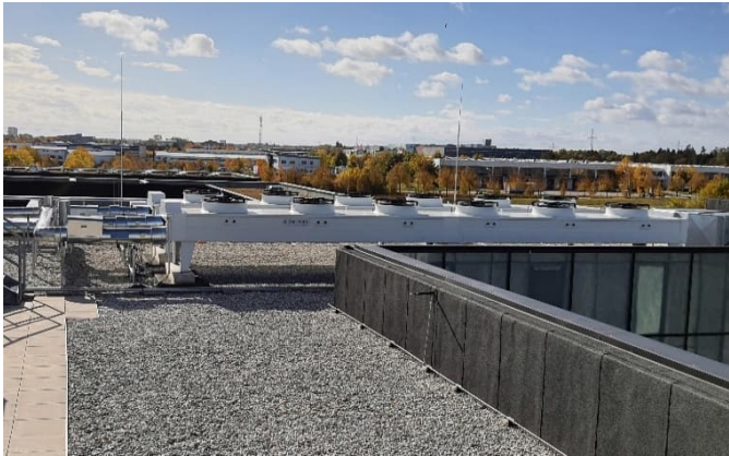
Rückkühler auf dem Dach
