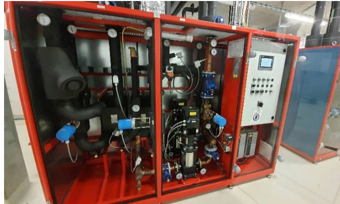
Wärmerückgewinnung für die Lüftungstechnik
