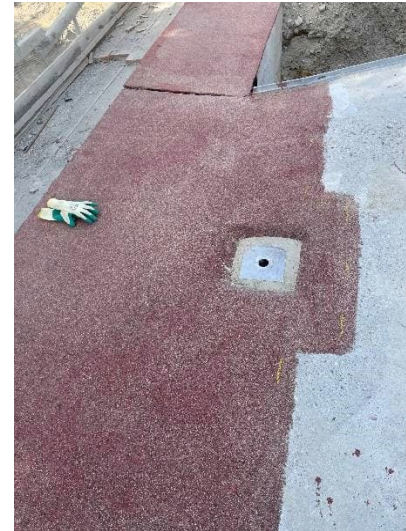
Tropftülle im Überbau
