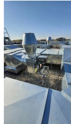
Sonderabluft auf dem Dach
